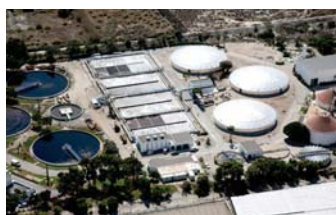
Ampliación de la EDAR El Bobar y agrupación de vertidos en núcleos de Almería y Huércal de Almería.
